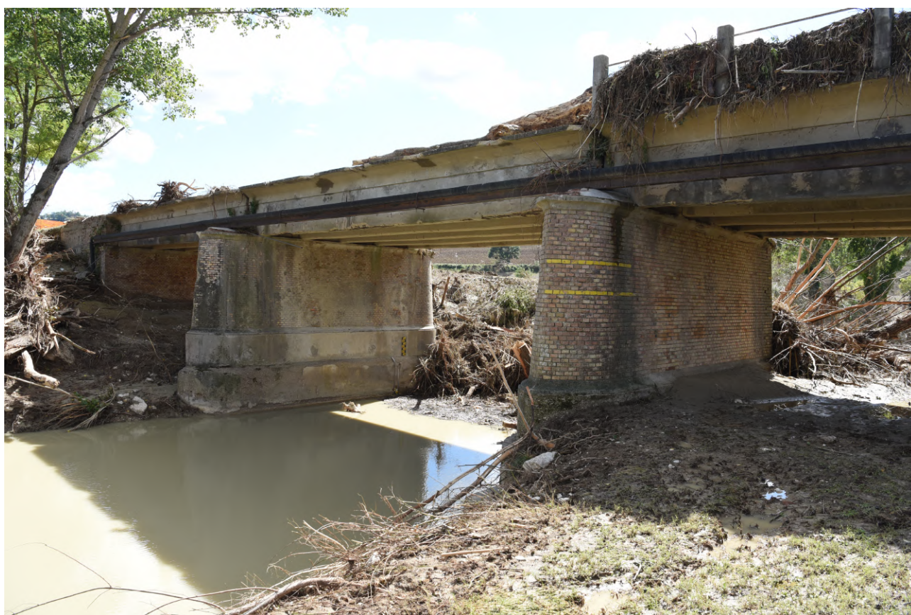
Figura 43: Ponte su cui era ubicato l'idrometro di Corinaldo sul fiume Nevola, portato via dalla piena del 15 settembre.
